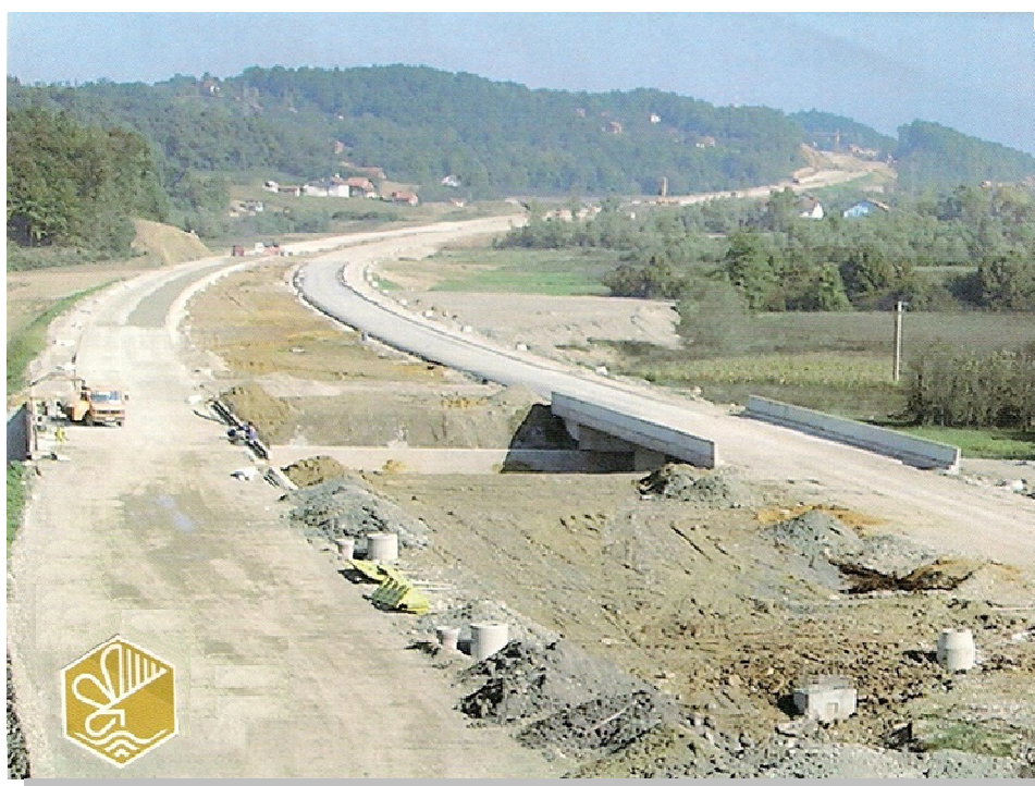
Slika 3 Upravljanje projektom: Auto put, izlaz BiH u Evropu Figure 3 Project management: Highway time out of BiH in Europe
